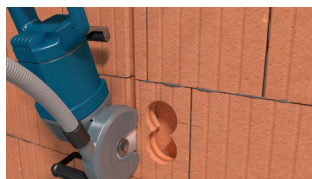
Schlitz mit Fräse neben Bohrungen fräsen, zusätzlich bis kurz vor oder in die Dosenbohrung fräsen.
